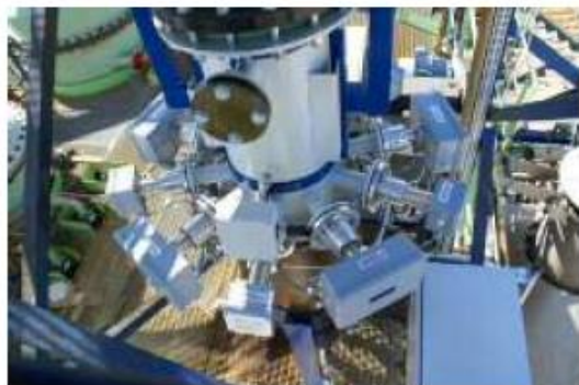
レーザー式ガス濃度計測装置
