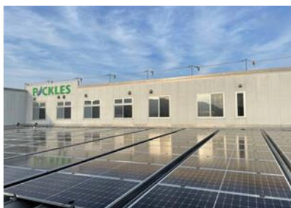
(株)ピクルスコーポレーション関西・ 広島工場の太陽光パネル (同社資料より)
