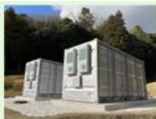
丹波篠山橋路蓄電所
