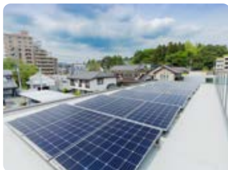
太陽光パネル
